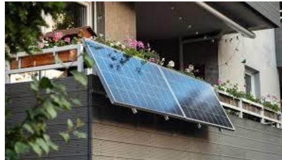
Sonnenenergie elektrisch wandeln und speichern
